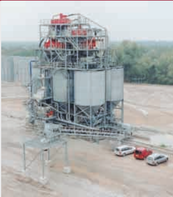
Abb. 4 | Siloanlage mit Sandaufbereitung Kieswerk Forchheim, Fa. Karl Eppe
